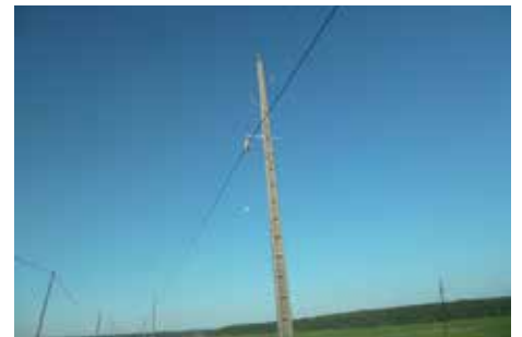
La fibre optique est supportée par le réseau électrique existant.
